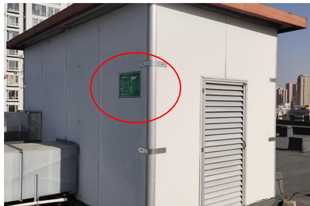
废气排放口标识牌
